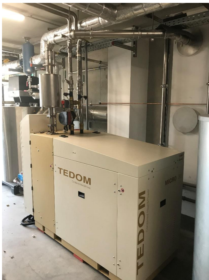
Ersatz eines Ölkessels durch ein BHKW
