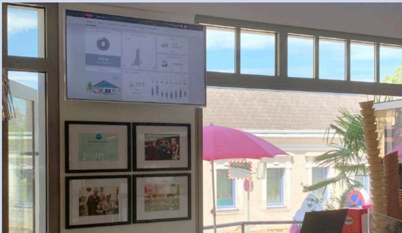
Der Monitor im Verkaufsraum liefert aktuelle Daten zum Energieverbrauch und zum Ertrag aus der PV-Anlage • Bild: Eisfux
